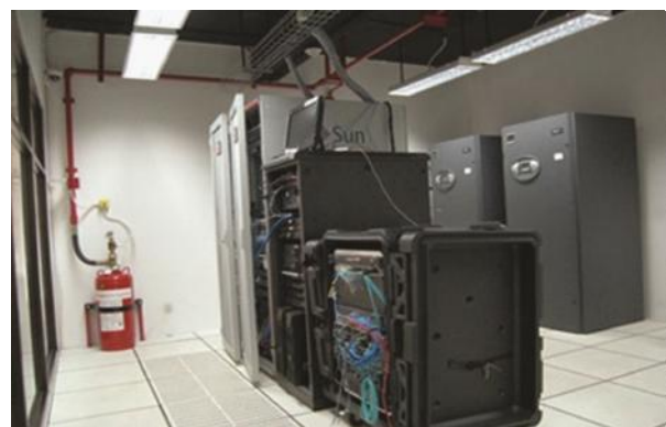
Ruang pusat data dan layanan server lingkup Balitbangtan.
